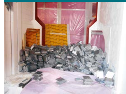
Bâtiment 18, dépose des protections biologiques (ici des briquettes de plomb) à l'arrière de l'enceinte Candide.
