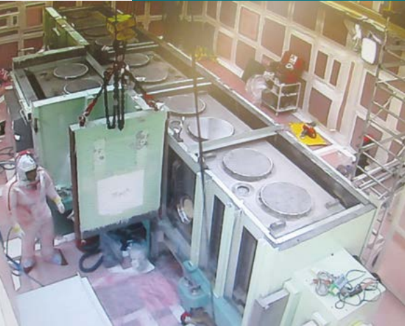
Bâtiment 18, dépose des protections biologiques (ici des plaques de plomb) de l'enceinte Carmen.
