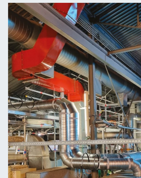
Photo de couverture: Montage de la nouvelle ventilation de Petrus ©CEA – UADF.
